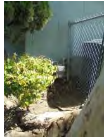
0002011e 4/24/2018 Gas meter Site
