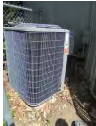
0002010e 4/24/2018 Condensing unit Site
