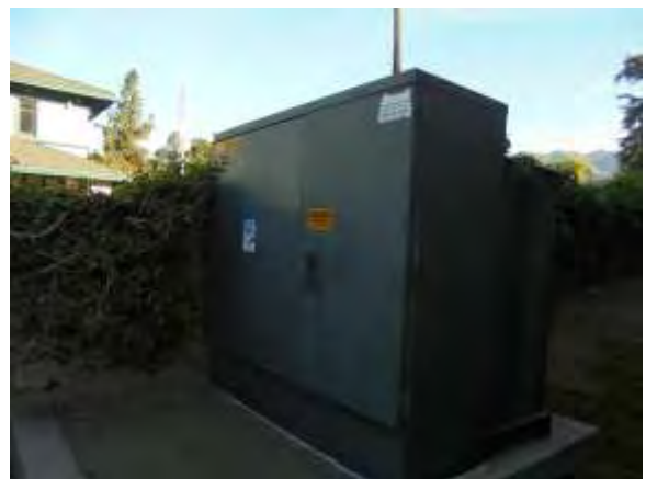
0001003e 4/24/2018 Transformer Site
