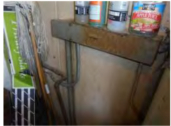
0002005e 4/24/2018 Conduit Mechanical/tool storage room
