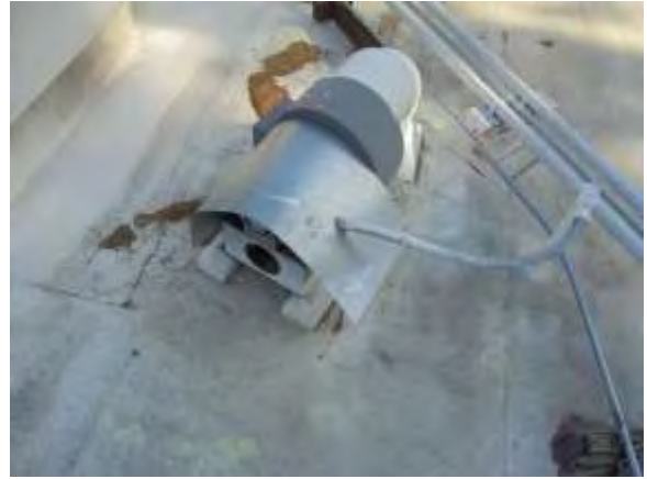
0001038e 4/24/2018 Exhaust fan Roof
