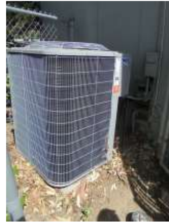
0002010e 4/24/2018 Condensing unit Site
