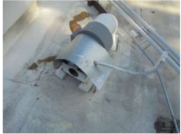
0001038e 4/24/2018 Exhaust fan Roof
