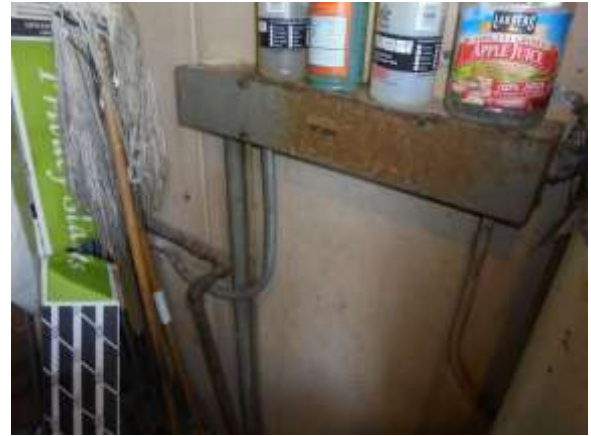
0002005e 4/24/2018 Conduit Mechanical/tool storage room
