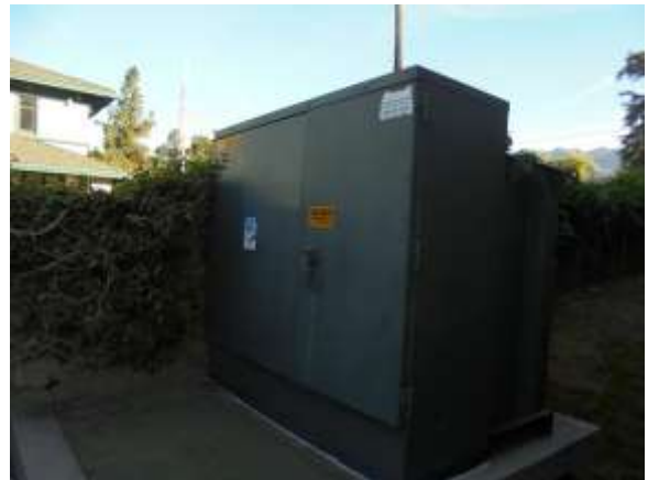
0001003e 4/24/2018 Transformer Site
