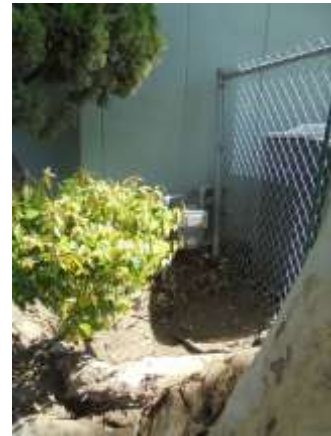
0002011e 4/24/2018 Gas meter Site
